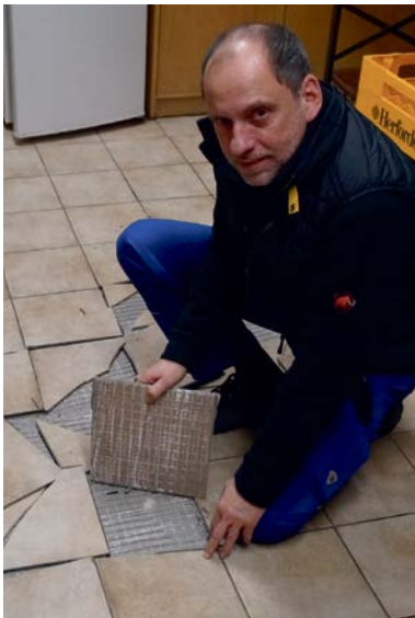
Oberstleutnant Dirk Lappe begutachtet den besonders sichtbaren Schaden: Im Arminius-Stübchen muss der geflieste komplett ausgetauscht werden. Foto: Bürgerschützenverein Bad Lippspringe e.V.
